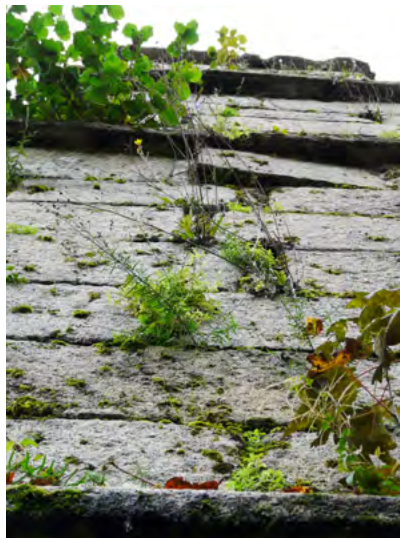
A la limite de rupture.
