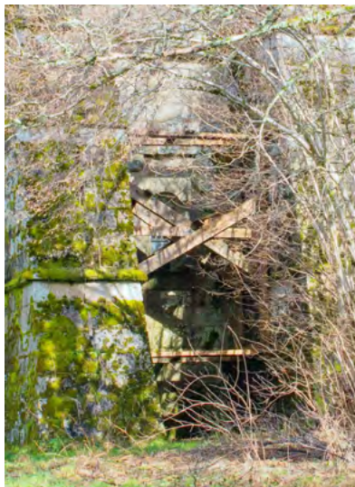
Étalement des parements (2009)
