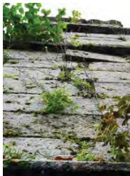
A la limite de rupture.
